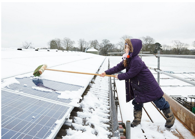
Når anlegg som det på bildet er dekket av snø, kan stående solcelleanlegg fortsatt produsere energi. (Foto: G. Hagedorn/Wikimedia commons)
