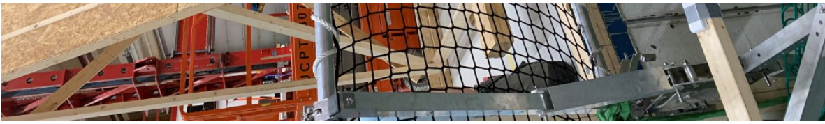
FANGET I NETTET: Her er stålsylindren trygt fanget i sikkerhetsnettet. (Foto: Jan-Fredrik Aasheim)
