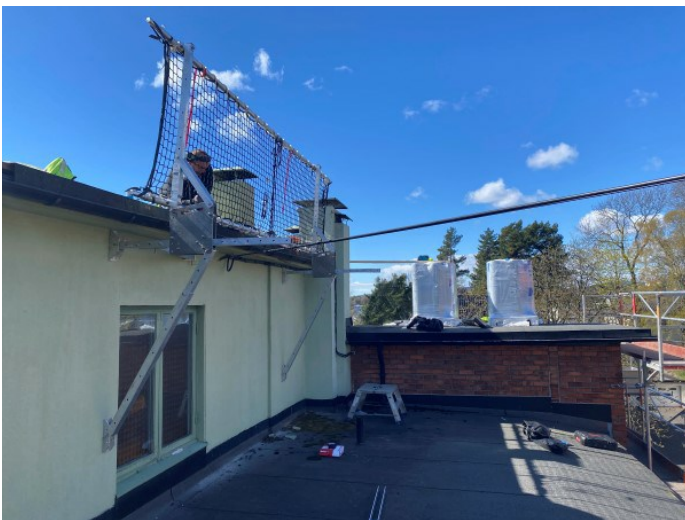
Storo Blikkenslagerverksted har deltatt i forskningsprosjektet med utprøving av ny taksikring under faktisk arbeid. (Foto: Safedesign)
